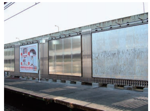
モジュール化が実現したサインボード (千駄ヶ谷駅)
